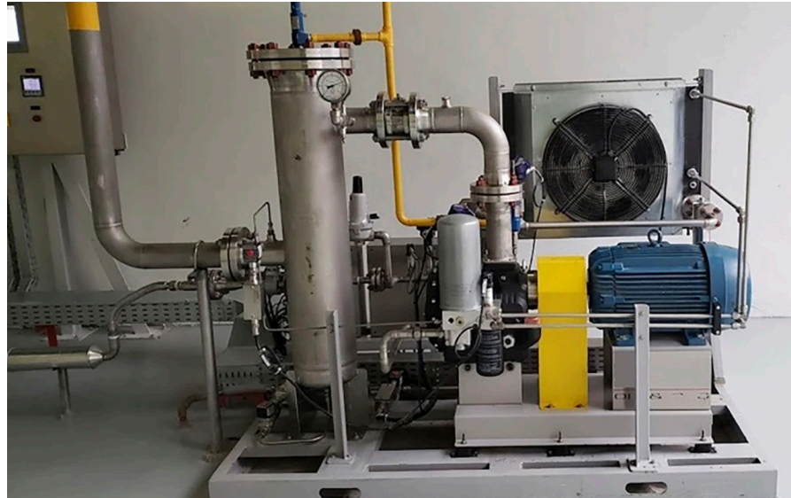
SWEP B10T All-stainlessろう付け式プレート熱交換器を採用したバイオガスシステム。
