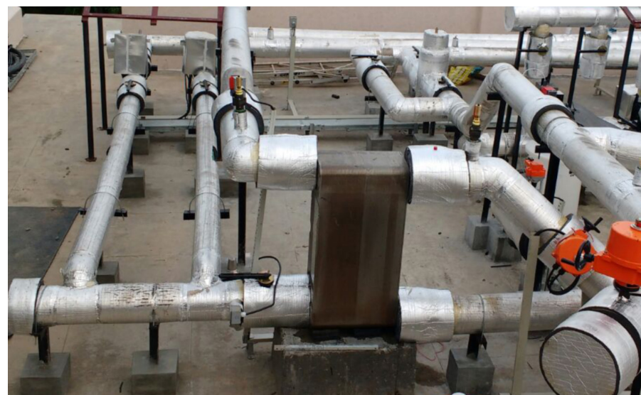
SWEP B439の設置
