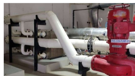
SWEP B439の設置
