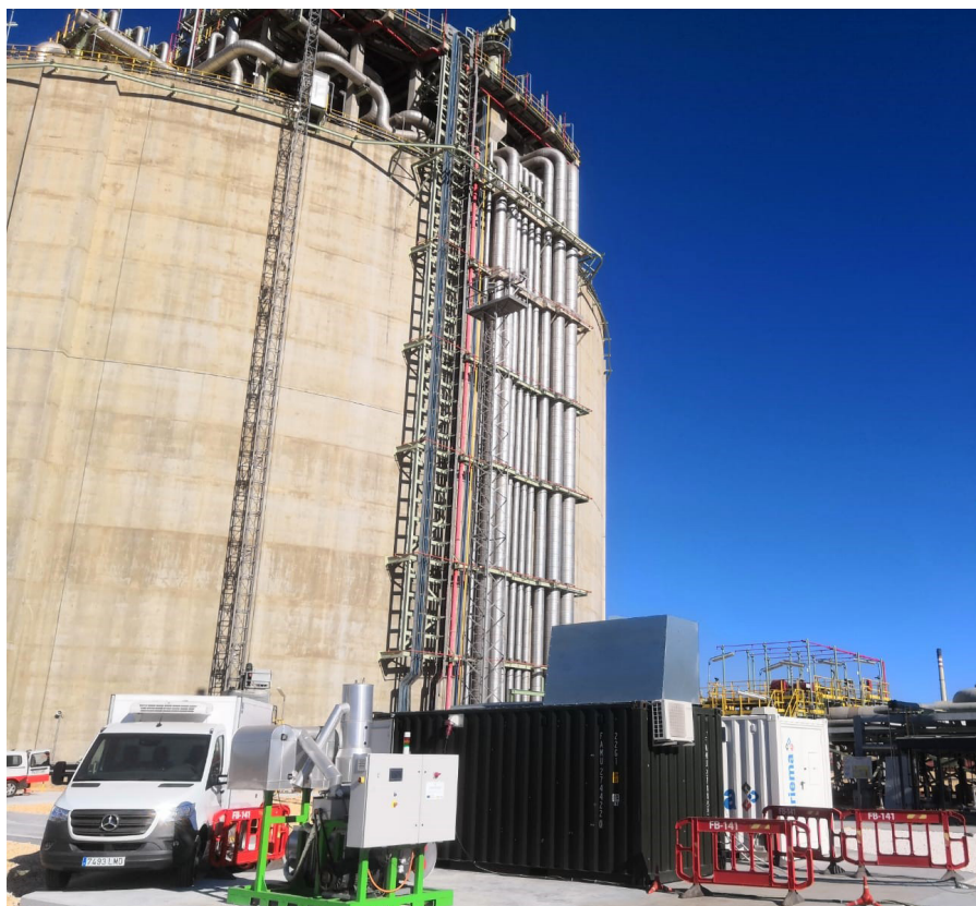
電気分解によるグリーン水素製造のためのクールスチームパイロット試験。
