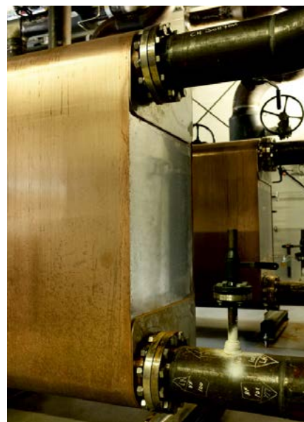
Due unità B649 di SWEP installate in parallelo.
