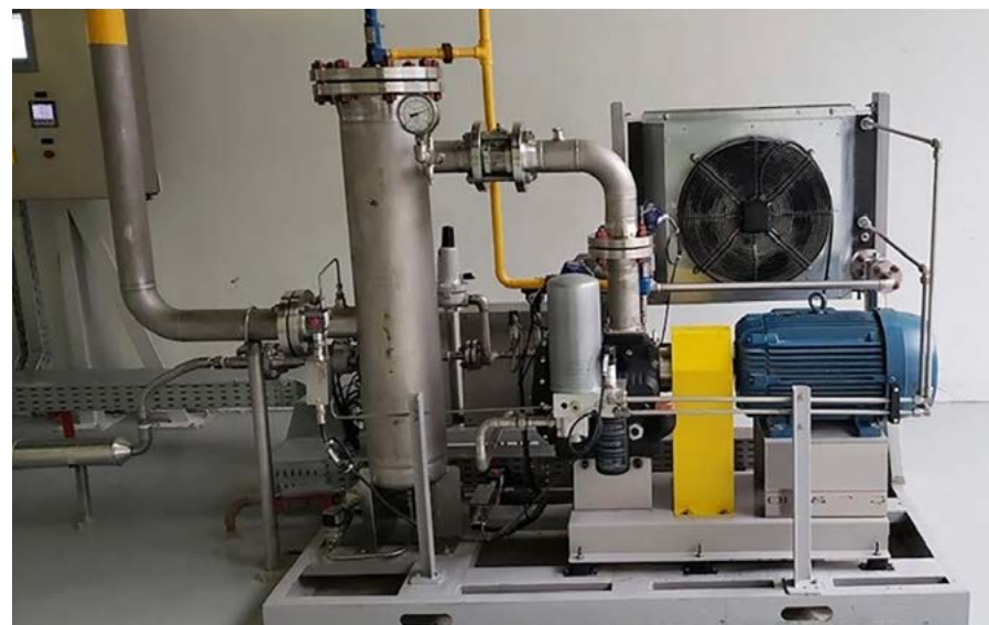
Sistema a biogas, dotato di scambiatori di calore a piastre saldobrasate SWEP B10T All-Stainless.
