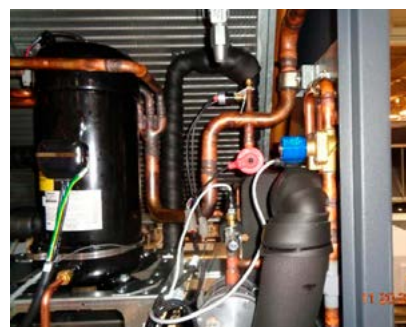
Installazione attuale di uno scambiatore di calore a piastre saldobrasate SWEP Q80ASx60 (isolato).
