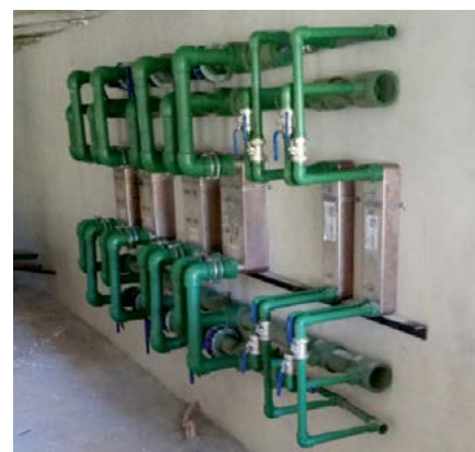
I BPHE di SWEP, installati in loco, forniscono il riscaldamento necessario.
