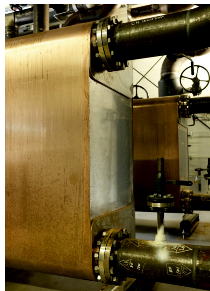
Deux unités SWEP B649 installées en parallèle.
