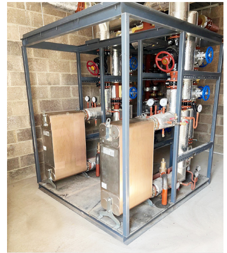
La solution de sous-station évolutive, qui utilise des échangeurs thermiques à plaques brasées SWEP B439Hx240.
