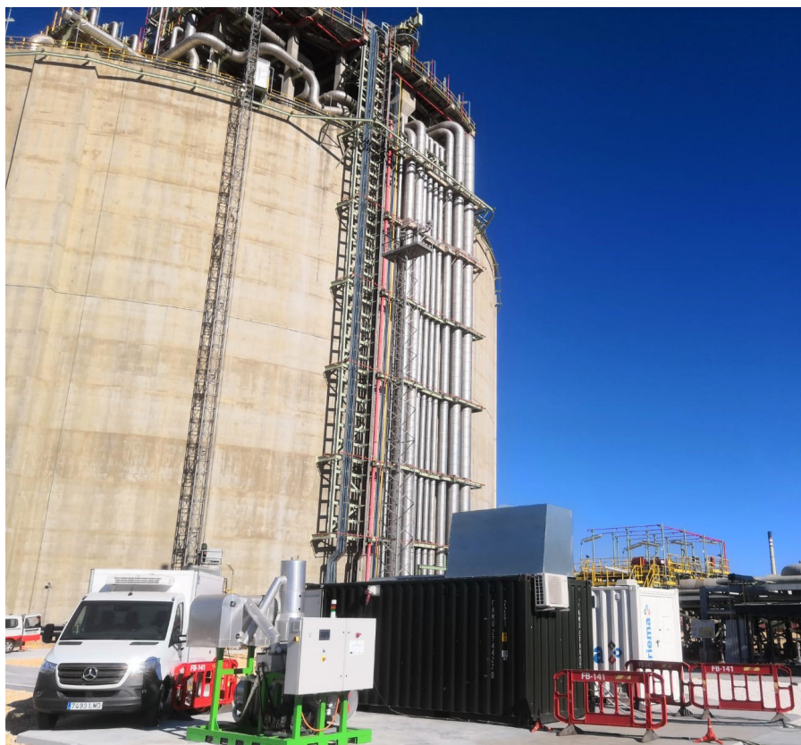
Essai pilote de Cool Steam pour la production d'hydrogène vert par électrolyse.
