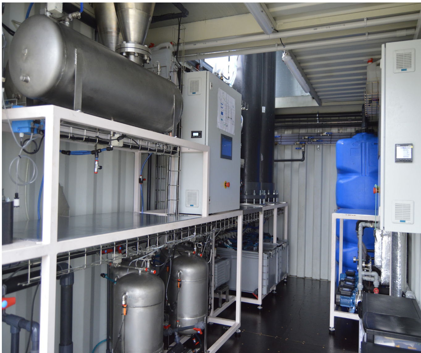
Une visite à l'intérieur de l'usine de démonstration opérationnelle de Barcelone.
