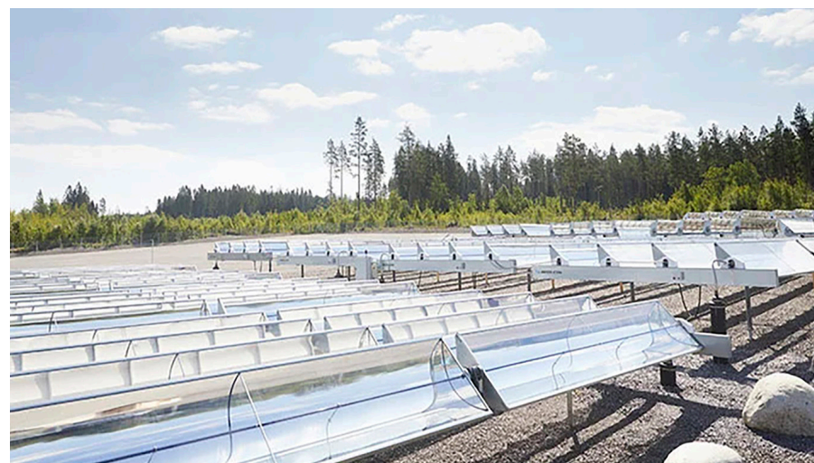
Le parc solaire d'Högslätten fournit de la chaleur et de l'eau chaude renouvelables à la ville.
