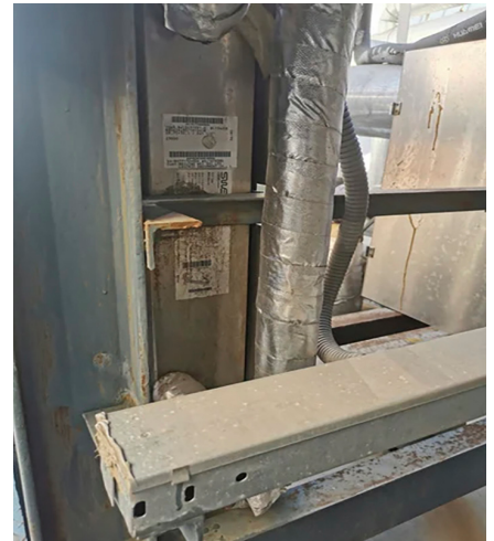
Einer der vor Ort installierten B80AS-Modelle von SWEP.
