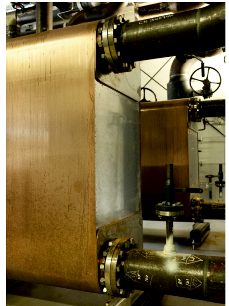
Zwei parallel installierte SWEP B649.
