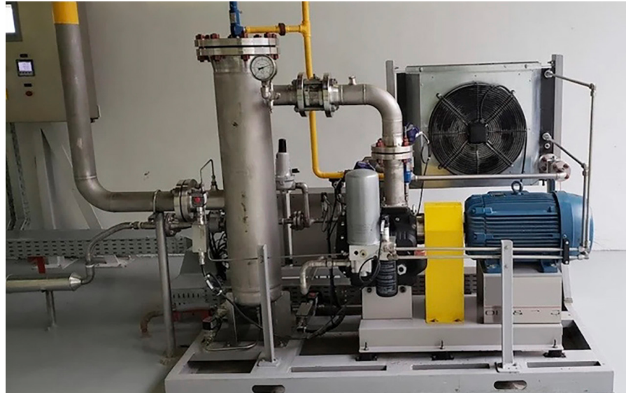
Biogasanlage mit dem gelöteten Plattenwärmetauscher B10T aus der SWEP All-Stainless-Serie
