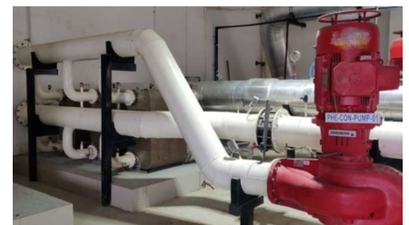
Installationsansicht eines B439 von SWEP.
