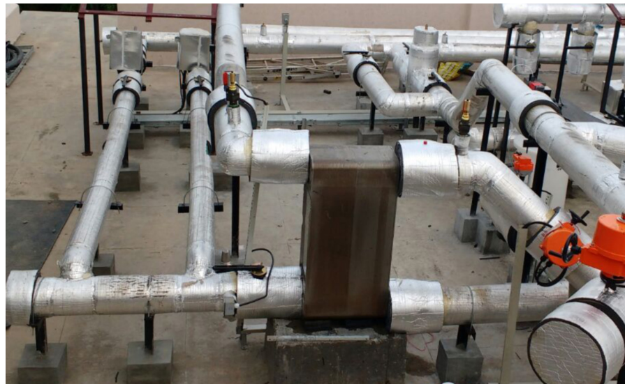
Installationsansicht eines B439 von SWEP.
