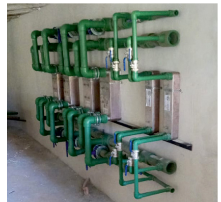
Die vor Ort installierten, gelöteten Plattenwärmetauscher von SWEP liefern die erforderliche Heizleistung.
