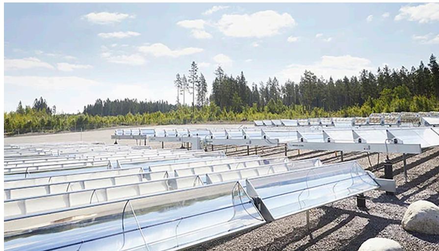
Der Solarpark Högsblätten versorgt die Stadt mit erneuerbarer Wärme und Warmwasser.
